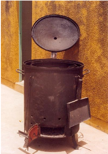
Financement d'un abri pour cet incinérateur de la maternité
