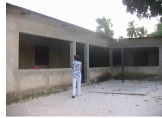
Sur les murs de l'école, les traces de la période des pluies
